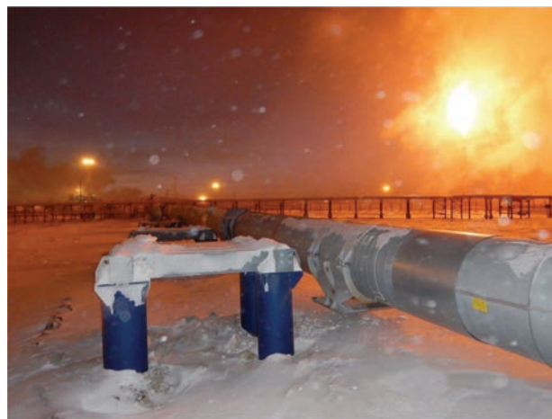
Рис. 1. Сход трубопровода с опорных поверхностей
